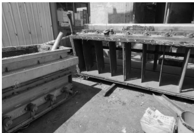
▲ 進行風門擋板連桿切割作業發生風門擋板倒塌致死。
