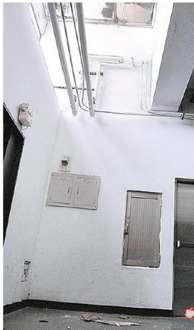
福山國小一名學童攀爬採光罩，踩破強化玻璃（圖2）墜落三公尺高的地下室
